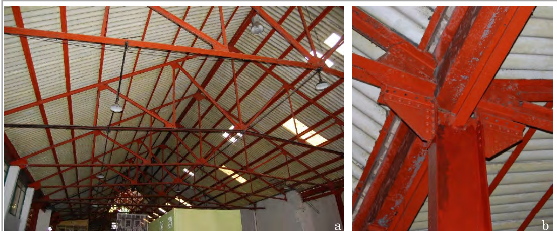
Ilustración 20. Santa Rosa aún presenta las armaduras de acero originales tipo “Howe” unidas con remaches y tornillos. Las columnas de sección “I” reciben las armaduras con ménsulas. EPG 2016.
