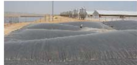
Segunda Etapa de Tratamiento de Aguas - Digester Anaeróbico
