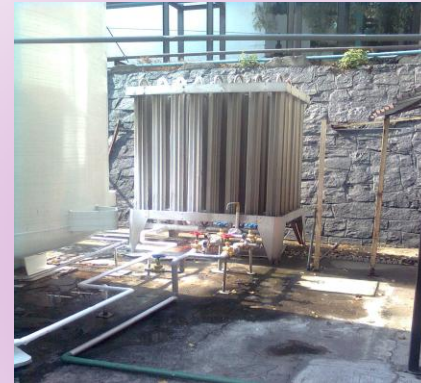
AIRE ACONDICIONADO IMAGEN OBTENIDA DEL HOSPITAL REGIONAL ISSSTE ADOLFO LÓPEZ MATEOS
