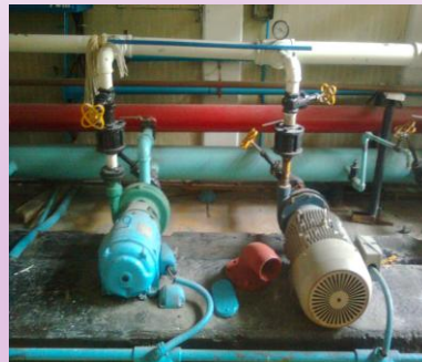
INSTALACIÓN HIDRAULICA (BOMBAS) IMAGEN OBTENIDA DEL HOSPITAL REGIONAL ISSSTE ADOLFO LÓPEZ MATEOS
