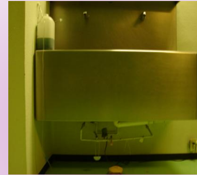
SALA DE QUIROFANO (ÁREA DE LAVADO) IMAGEN OBTENIDA DEL HOSPITAL REGIONAL ISSSTE ADOLFO LÓPEZ MATEOS
