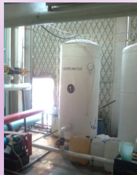
HIDRONEUMÁTICO IMAGEN OBTENIDA DEL HOSPITAL REGIONAL ISSSTE ADOLFO LÓPEZ MATEOS
