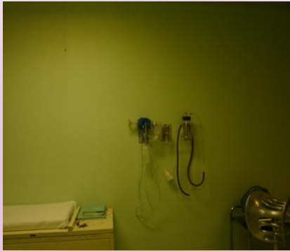
SALA DE QUIROFANO (ADMINISTRACIÓN DE GASES) IMAGEN OBTENIDA DEL HOSPITAL REGIONAL ISSSTE ADOLFO LÓPEZ MATEOS
