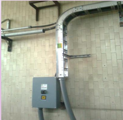
CANAleta DE TELECOMUNICACIONES Y TABLERO IMAGEN OBTENIDA DEL HOSPITAL REGIONAL ISSSTE ADOLFO LÓPEZ MATEOS
