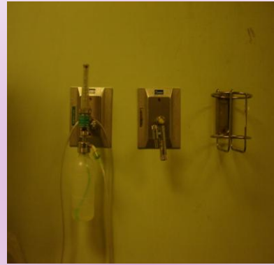
DISTRIBUCIÓN DE GASES IMAGEN OBTENIDA DEL HOSPITAL REGIONAL ISSSTE ADOLFO LÓPEZ MATEOS
