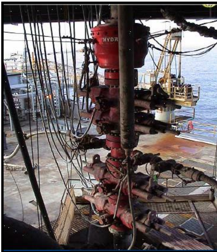
Figura 3.1 Arreglo de preventores
