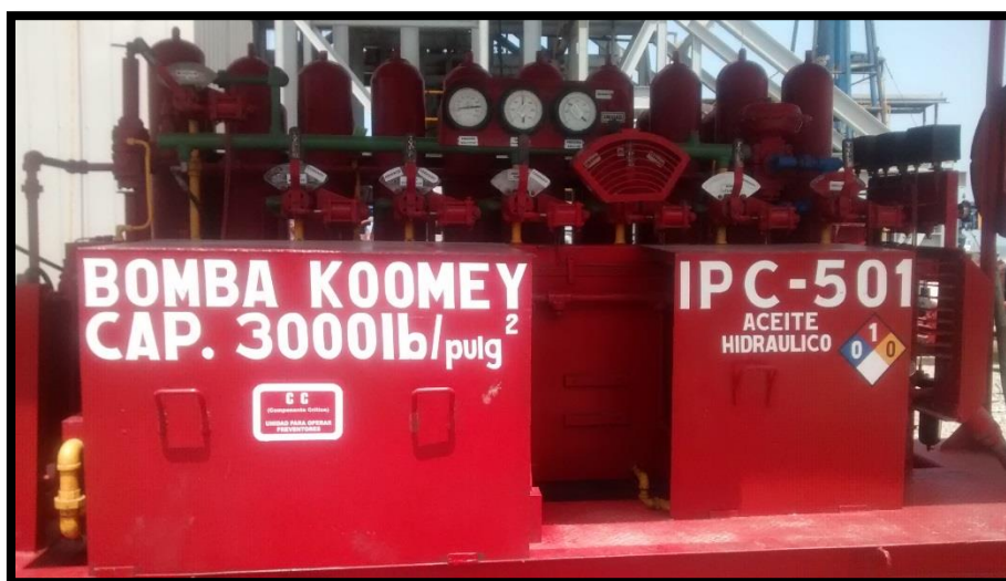
Figura 3.16 Unidad para operar preventores.
