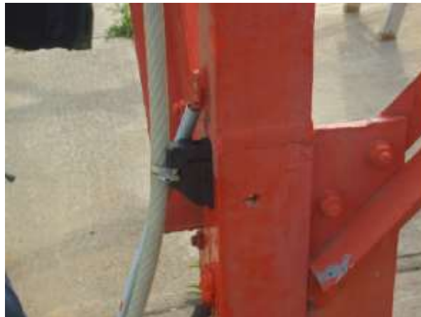
Figura 4.6 Modo de sujeción del cable del pararrayos
