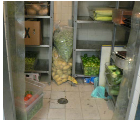
Figura 14. Cámara de refrigeración, TM.
