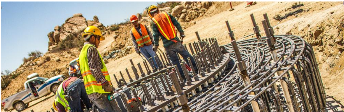
Figura 4.14 Construcción de cimientos para los postes de los aerogeneradores del proyecto “Energía Sierra Juárez”
