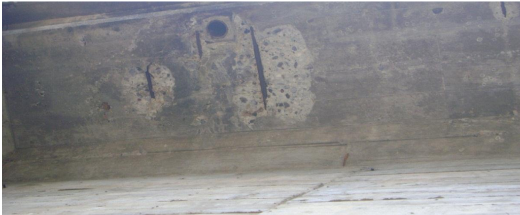
Imagen: 2.1. Puente La Huacana II, trabe con acero expuesto.
