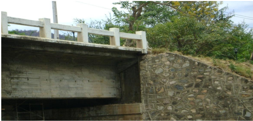
Imagen: 3.4. Puente La Huacana II, antes de la reparación.
