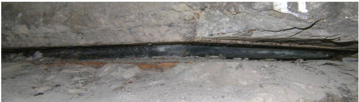
Imagen: 2.4. Puente La Huacana II, neopreno con desgaste severo.
