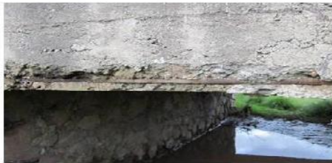
TRAMO 1-2, LADO AGUAS ARRIBA. VISTA LATERAL DE LOSA ACERO DE REFUERZO EXPUESTO.
