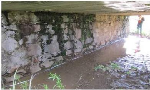
PILA EJE 2 LADO, ESTRIBO EJE 1. ESCURRIMIENTO POR MAL FUNCIONAMIENTO DE JUNTA.
