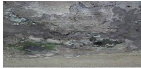
TRAMO 1-2, LADO AGUAS ABAJO. VISTA INFERIOR DE LA LOSA CONCRETO DEFIORADO
