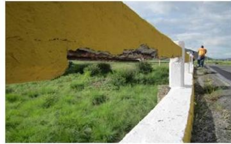
TRAMO 2-3, LADO AGUAS ARRIBA. ACERO EXPUESTO EN TRABE DE PARAPETO.
