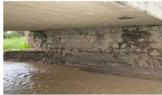
PILA EJE 2 LADO, LADO ESTRIBO PILA 3. ESCURRIMIENTO POR MAL FUNCIONAMIENTO DE JUNTA.
