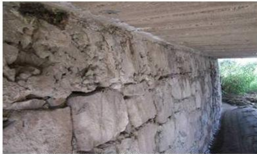
PILA EJE 2, LADO PILA EJE 3. CORONA CON DEFECTOS DE COLADO
