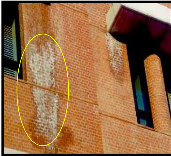
Fotografía 2 Sales eflorescentes en construcciones. Fuente: http://www6.uniovi.es/usr/fblanco/TEMAII.2.6.QUIMICAS.pdf
