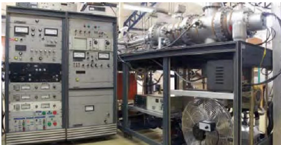
Figura No. 2.- Tubo de deriva y paneles de control.
