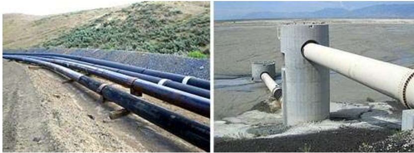
Figura 1.1.- Conducción por tuberías de los relaves mineros hasta la disposición final. (www.tailings.info)
