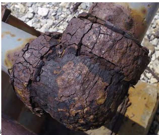
Figura 1.14 Tubería que presenta corrosión por erosión. 15
