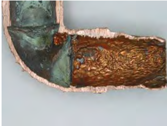
Figura 1.12 Ejemplo de severa erosión por cavitación en una tubería. 13
