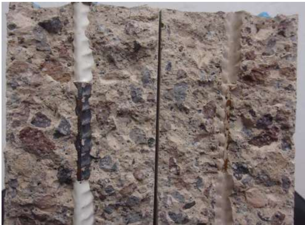
Figura 3.36.- Detalle del concreto con agregado natural carbonatado.
