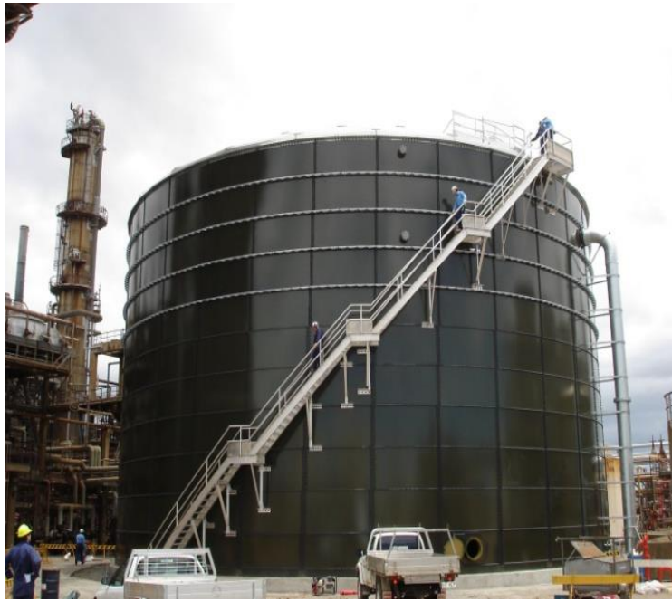
Ilustración 31: tanque de almacenamiento de producto
