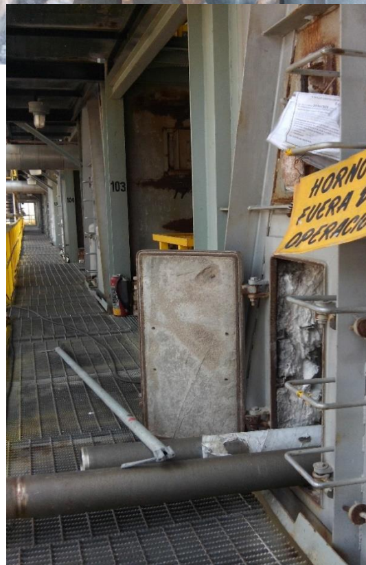
Ilustración 37: Condiciones inseguras en interior como exterior de horno
