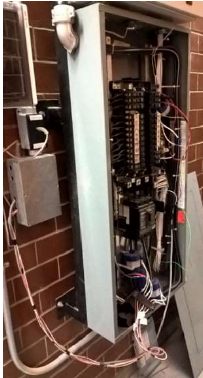
Figura 4.1 Medidor de Consumo EA instalado en el edificio 5 del Instituto de Ingeniería de la UNAM
