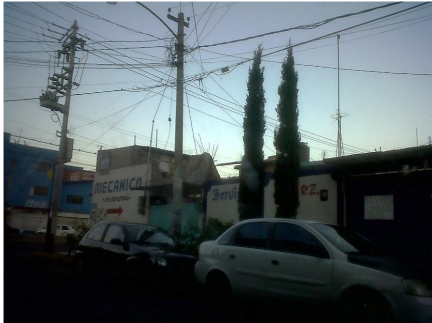
Fig. II-4 CABLES DE LUZ
