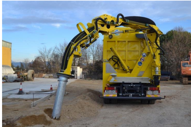
Figura 2.1.3.1 Ejemplo excavadora de succión.
