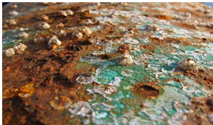
Figura 2 Pieza con corrosión microbiológica
