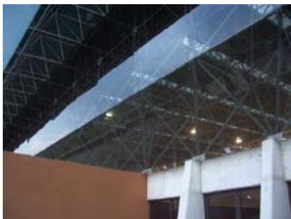
Imagen. Estructura exterior Fuente cnar.gob.mx
