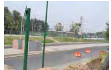
Fig 4.33. Condición actual del talud del lado poniente.
