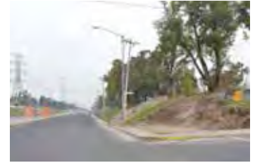
Fig 4.32. Condición actual del talud del lado oriente
