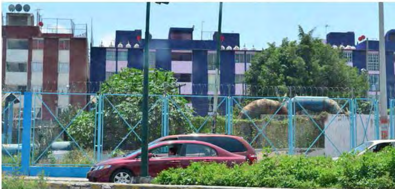
Fig 2.68. Planta de bombeo- Instalación Hidráulica (foto referida en el plano fig. 2.66)
