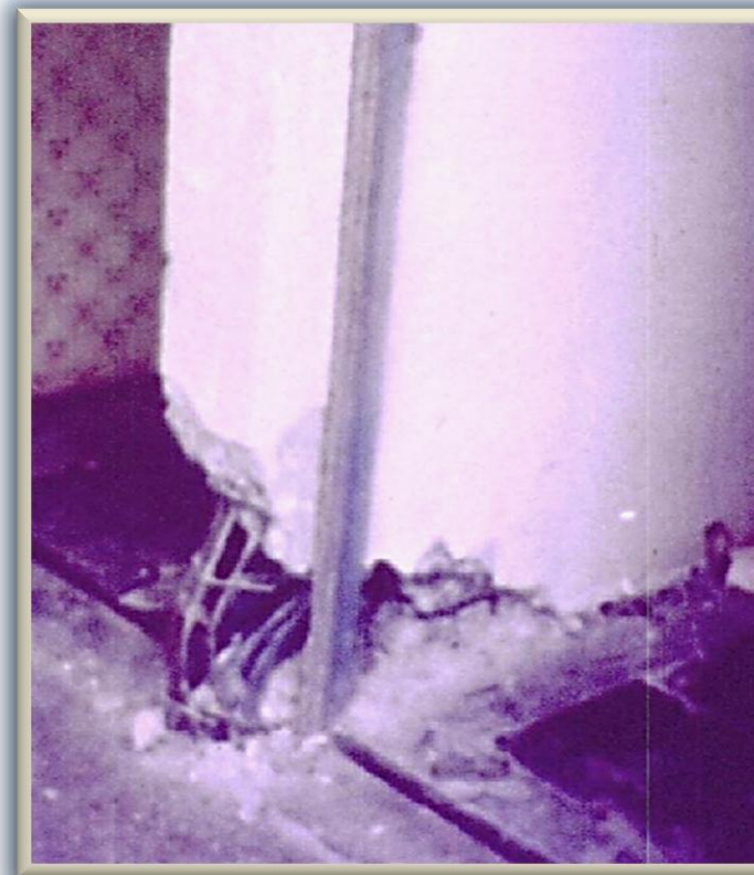
Fig. 1.2.1.e.2-2) Esquema y ejemplo real de falla por flexión en dirección del plano del muro, provocando aplastamiento de concreto y pandeo de barras en extremo de base (talón)
