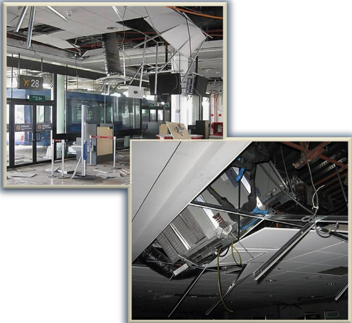
Fig. 2.6.1. Ejemplos de daños típicos en elementos no estructurales. Arriba, caída de falso plafón en una Terminal aérea de Chile. Abajo, desprendimiento de un equipo de aire acondicionado en el mismo edificio Terminal
