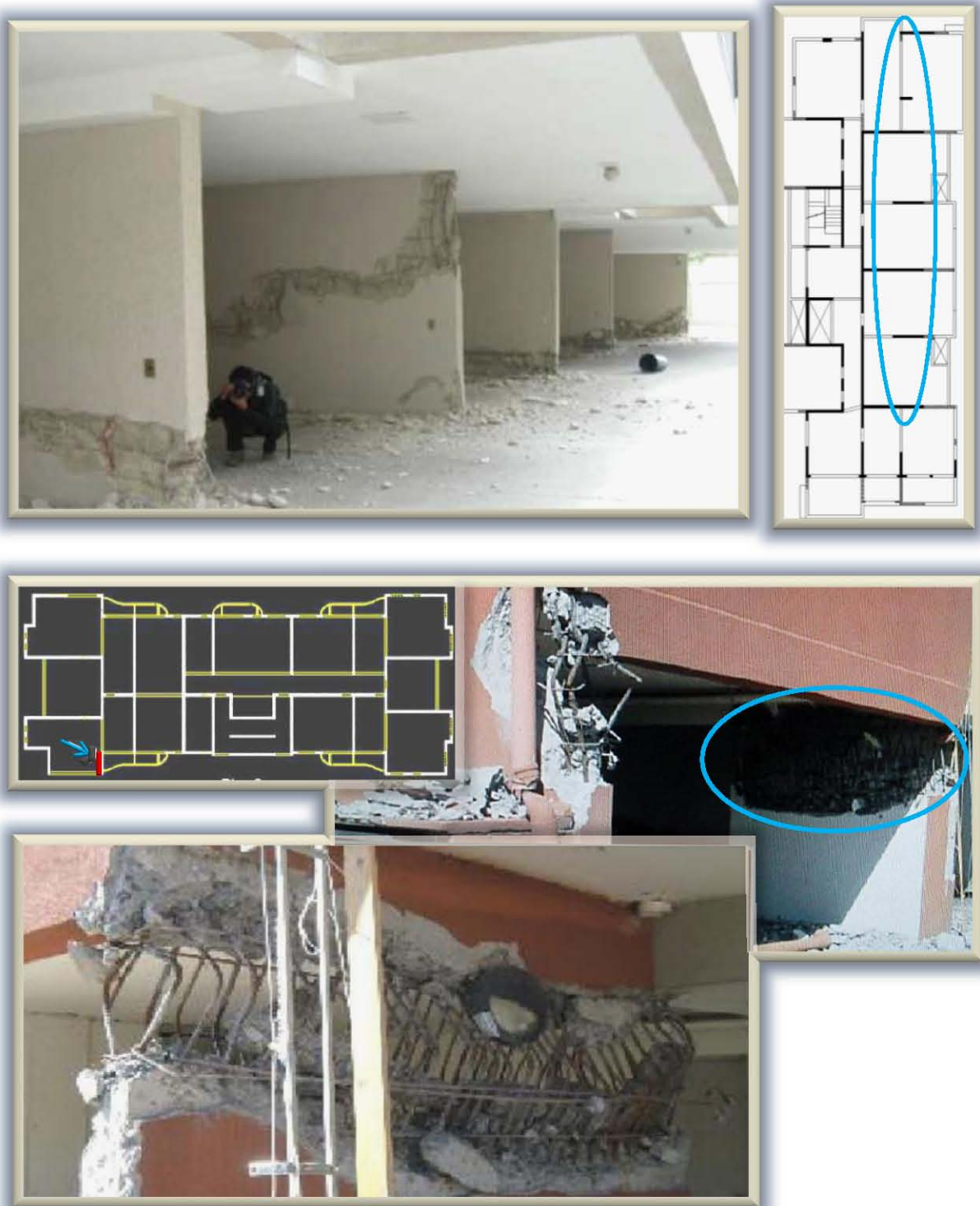
Fig. 1.2.1.e.2-3.1) Otros ejemplos de falla por flexión y por combinación de cargas. Arriba, agrietamiento generalizado y aplastamiento de concreto en la base de muros de igual orientación. Abajo, desprendimiento masivo de concreto en corona de muro, así como gran deformación, incluso cizalle (en otro muro) del refuerzo vertical, por posible efecto combinado de flexión y cortante aunado a la concentración de esfuerzos de compresión axial
