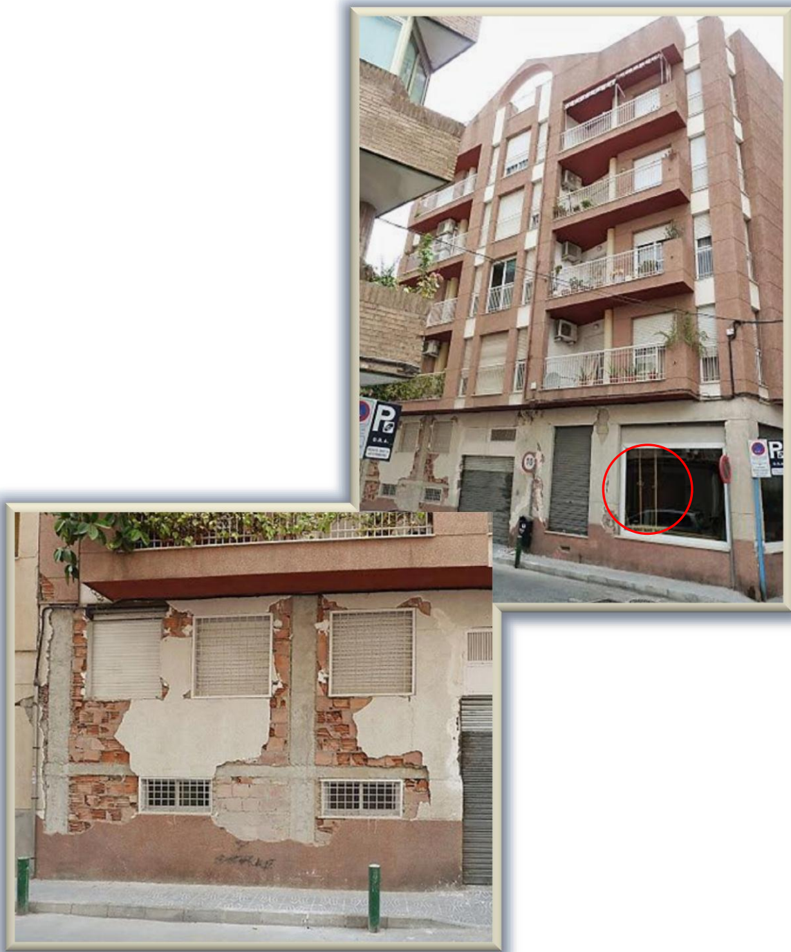
Fig. 2.1.2.13.a) Edificio de concreto armado y mampostería después de un sismo. En el exterior no se notaba muy afectado, pero en el interior presentó daños muy severos, principalmente en varias columnas de la planta baja, las cuales se decidió reforzar, implementándose primeramente un apuntalamiento a base de perfiles de acero (fig. siguiente)
