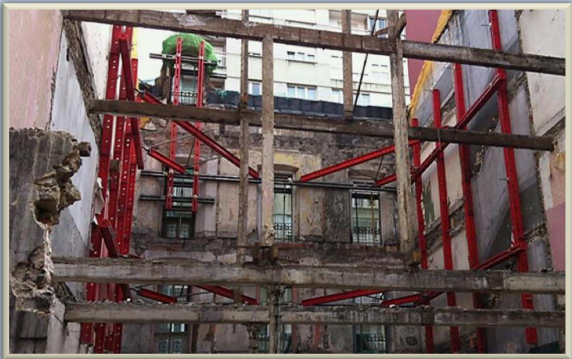
Fig. 2.1.2.15 Apuntalamientos “estabilizadores” a base de perfiles metálicos con arriostramientos horizontales coplanarios y oblicuos, que cuando se colocan interiormente, como en estos ejemplos, al diseñarlos debe preverse que no interfieran con los trabajos de rehabilitación
