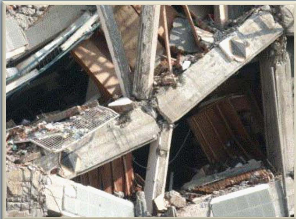
Fig. 1.2.1.c.2-2.1) Más ejemplos de fallas en uniones viga-columna que por anclaje insuficiente o falta de refuerzo y rigidez en el núcleo provocan desplazamientos excesivos que culminan en colapso generalizado de la estructura
