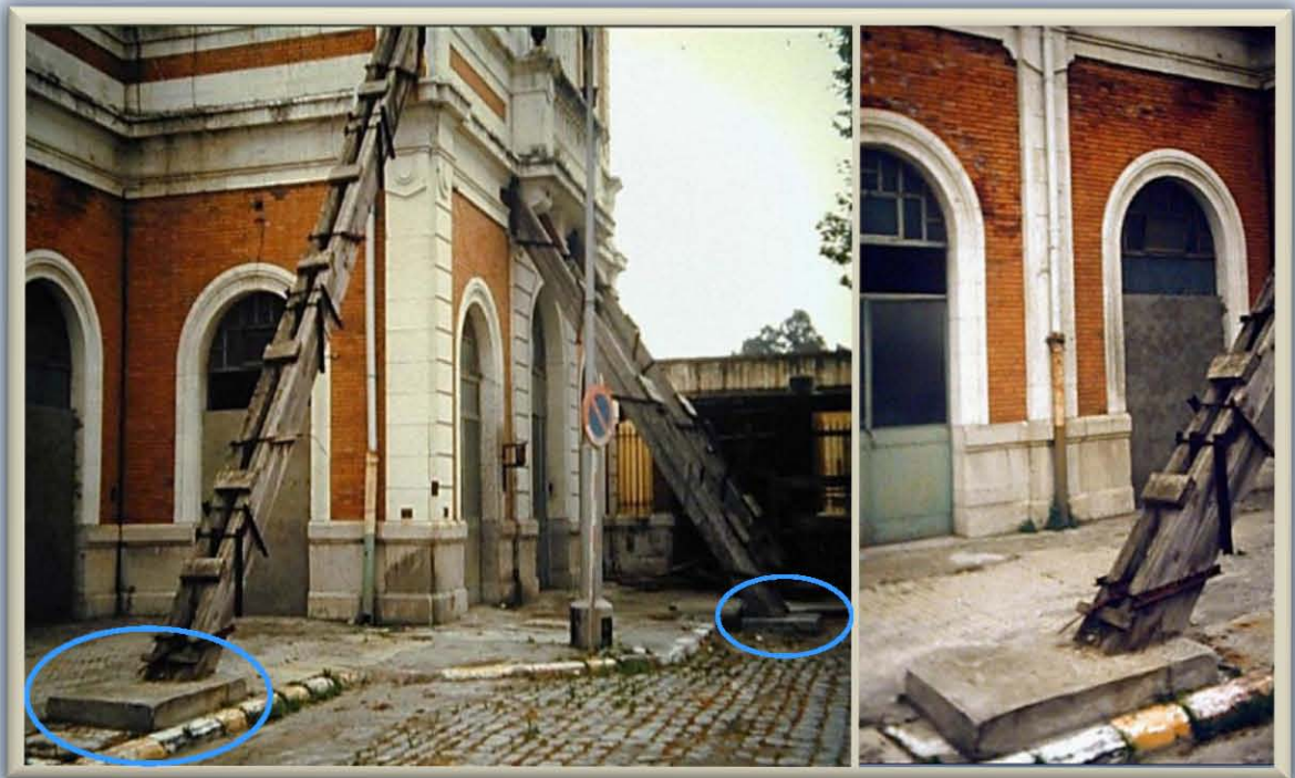
Fig. 2.1.3.5. Apuntalamientos constituidos por elementos de grandes dimensiones. Arriba, 2 líneas de puntales en paralelo dando soporte en dos niveles de portal de mampostería. Abajo, puntales dobles largos conformados con vigas unidas con bridas de acero y tablillas. En ambos, nótese dado de concreto que se forja para empotrar la base de los puntales.
