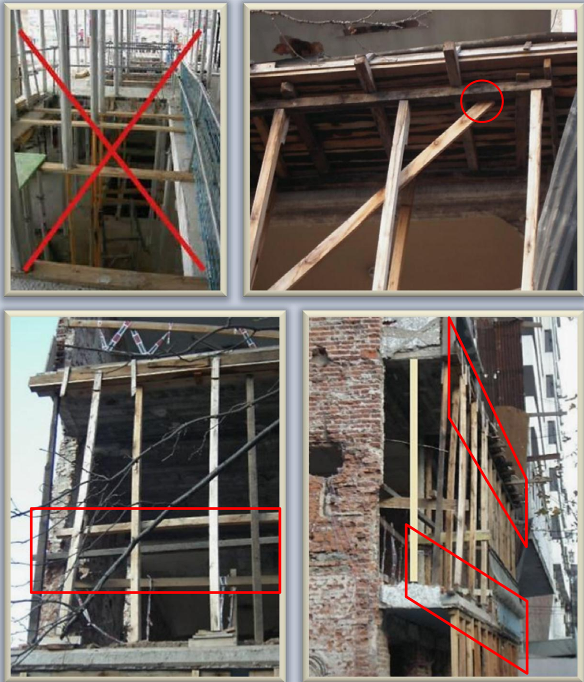
Fig. 2.1.2.10 Formas incorrectas de apuntalar. Arriba a la izquierda, se infringe el primer principio básico de todo apuntalamiento: estar firmemente apoyado. Arriba a la derecha, el arriostamiento no remata en el nodo. Abajo a la izquierda, el aparente arriostamiento horizontal no es equidistante, y el acuñaamiento de los puntales es defectuoso. Abajo a la derecha, el apuntalamiento de un balcón debe efectuarse al centro para que la losa de éste continúe trabajando en voladizo
