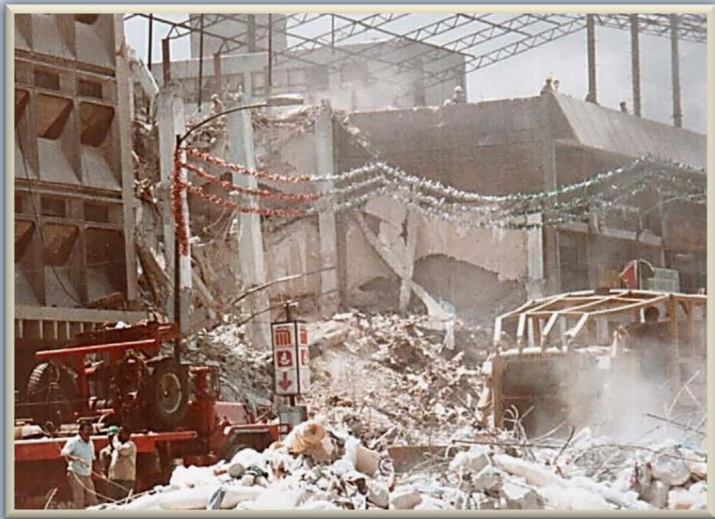
Fig. 1.2.1.c.2-1.2) Ejemplos reales de fallas por penetración en losas planas, que originó el colapso total de entresijos, no obstante de haber permanecido en pie y casi inalteradas varias columnas
