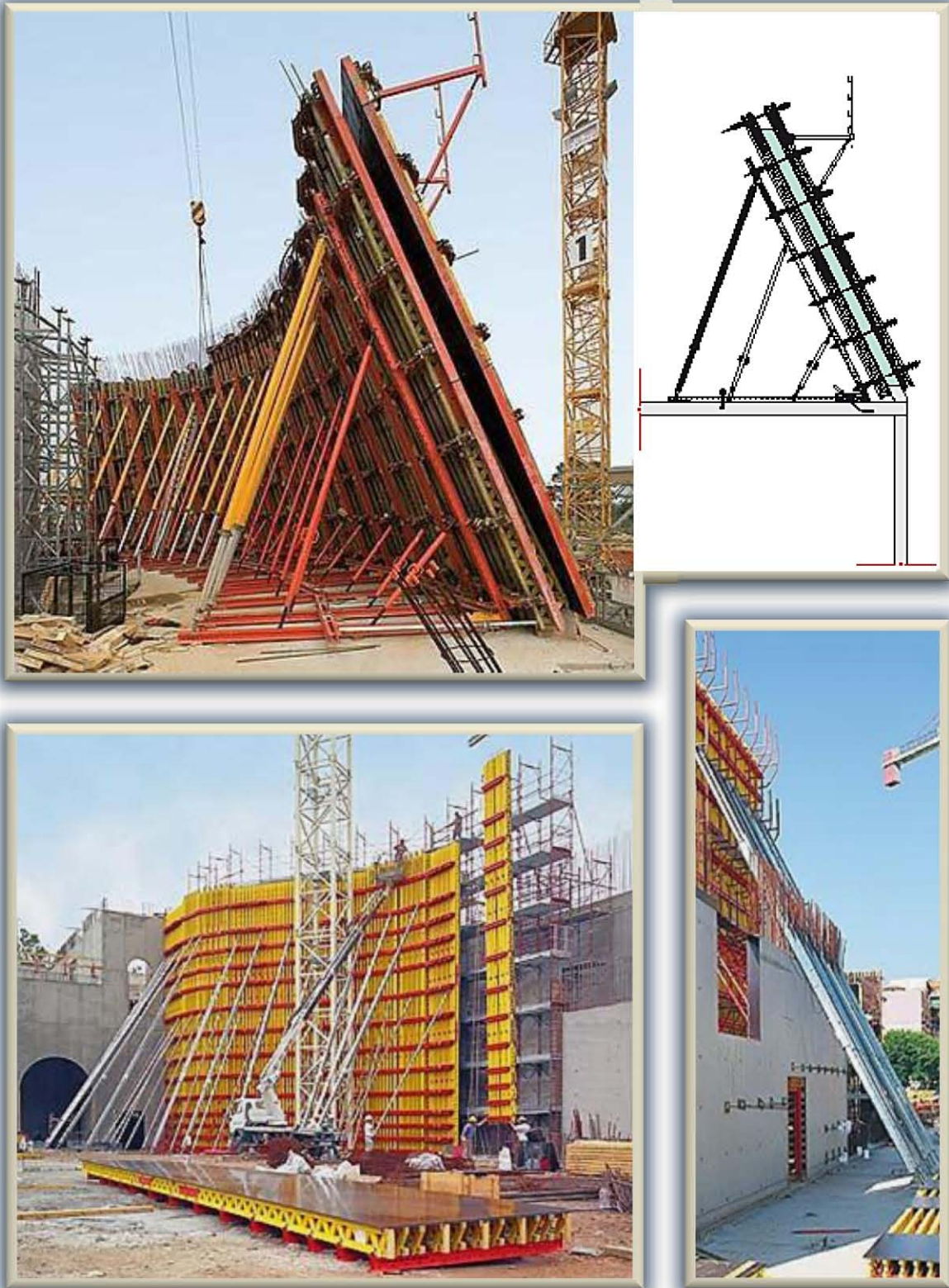
Fig. 2.1.3.6. Apuntalamientos oblicuos con puntales metálicos de gran capacidad de carga. Arriba, sistema triangular de 3 puntales paralelos soportando cimbra inclinada. Abajo, puntales telescópicos de acero alcanzando 14 m. de altura
