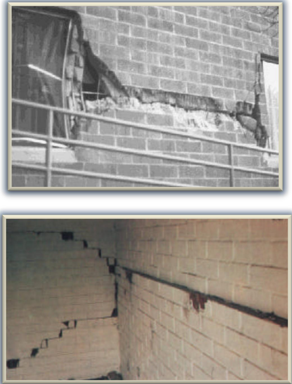
Fig. 1.2.1.f.2-2.1) Ejemplos reales de fallas por flexión en mampostería. Arriba, en dirección del plano, fractura de bloques y pandeo del refuerzo vertical. Abajo, en dirección perpendicular, deslizamiento a lo largo de junta de unión de tabiques a media altura y separación de porción del muro transversal
