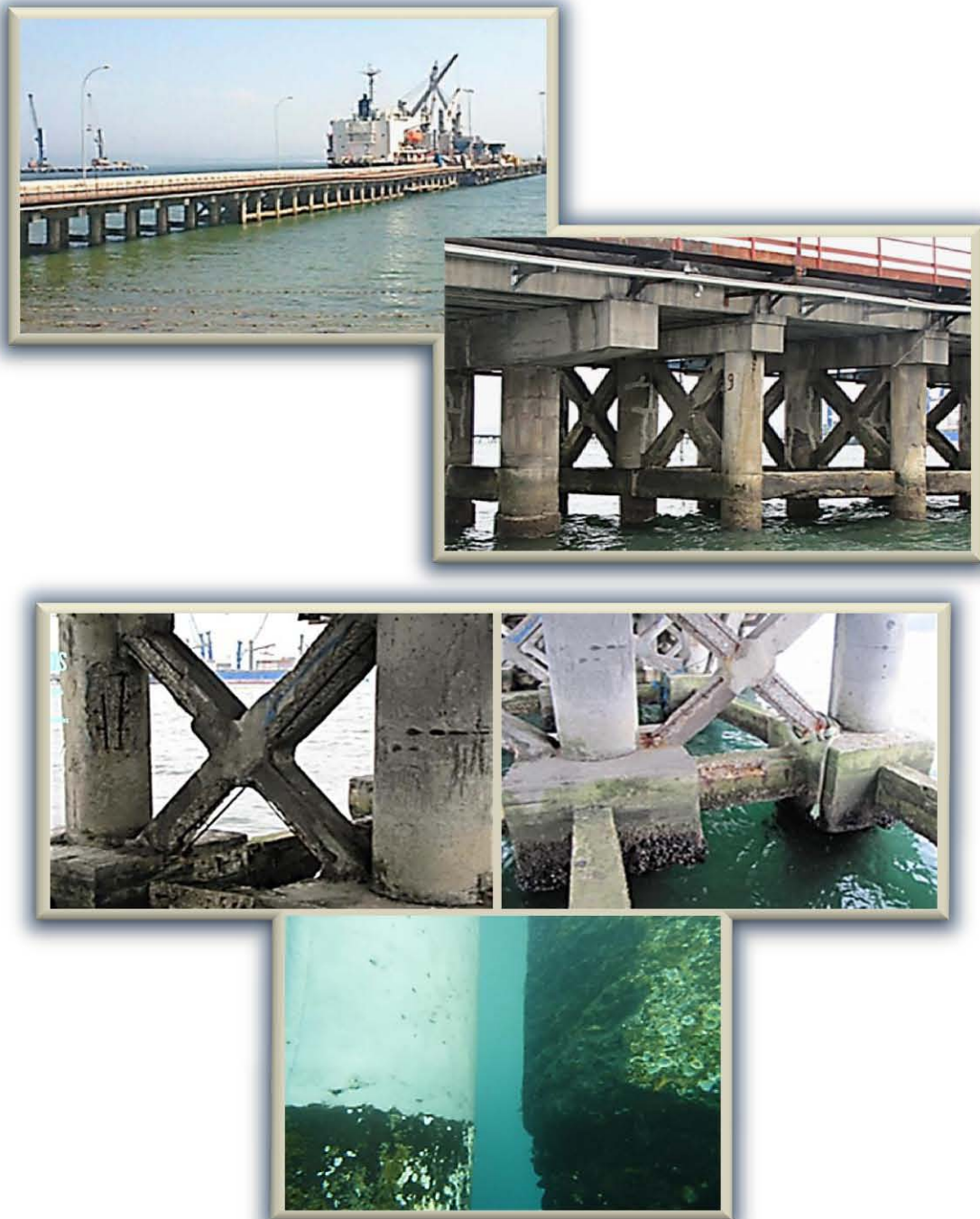
Fig. 3.3.1. Rehabilitación del muelle No. 1 del "Puerto Lirquen" de Chile, destinado a embarcaciones de gran calado. Arriba, vista longitudinal y acercamiento de los componentes estructurales del muelle, los cuales presentan severas afectaciones. Abajo, degradación del concreto por el fuerte intemperismo del ambiente marino
