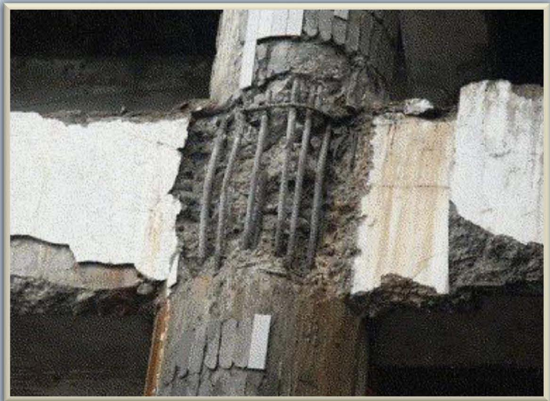
Fig. 1.2.1.c.2-1) Ejemplos reales de fallas en nodos de viga y columna. La falta de refuerzo transversal ocasiona caída de recubrimiento y agrietamiento diagonal por cortante
