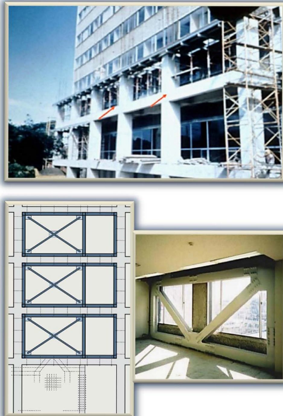
Fig. 2.5.2.3. Adición de marcos para reestructuración de edificios. Arriba, construcción de marcos perimetrales de concreto. Abajo, esquema e imagen de marcos arriostrados de acero, añadidos interiormente
