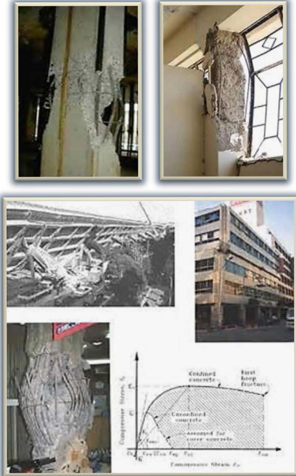
Fig. 1.2.1.a.2-3) Más fallas por flexocompresión. Nuevamente nótese el desprendimiento de concreto y pandeo de barras
