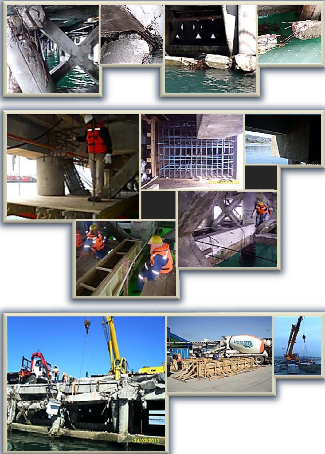
Fig. 3.3.3. Fuertes daños por sismo y colisión; métodos de reparación aplicados. Arriba, nodos y traves inferiores colapsados por sismo. En medio, reconstrucción de nodos viga-pilote y traves de liga inferiores, con concreto armado. Abajo, vigas superiores destruidas por impacto de embarcación, que fueron repuestas con elementos de concreto precolados "in situ"
