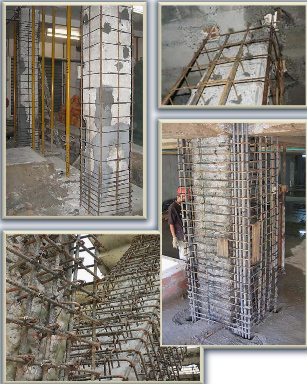
Fig. 2.4.1.4. Armados de encamisados típicos de concreto reforzado. Arr.izq., el tipo más simple, una sólo capa de refuerzo distribuido uniformemente alrededor. Arr.der., vista de cerca de anclaje a columna y paso a través de losa. Ab.izq., elementos con gran cantidad de conectores para anclaje. Ab.der., refuerzo concentrado en las esquinas y colado conjunto con porción de losa
