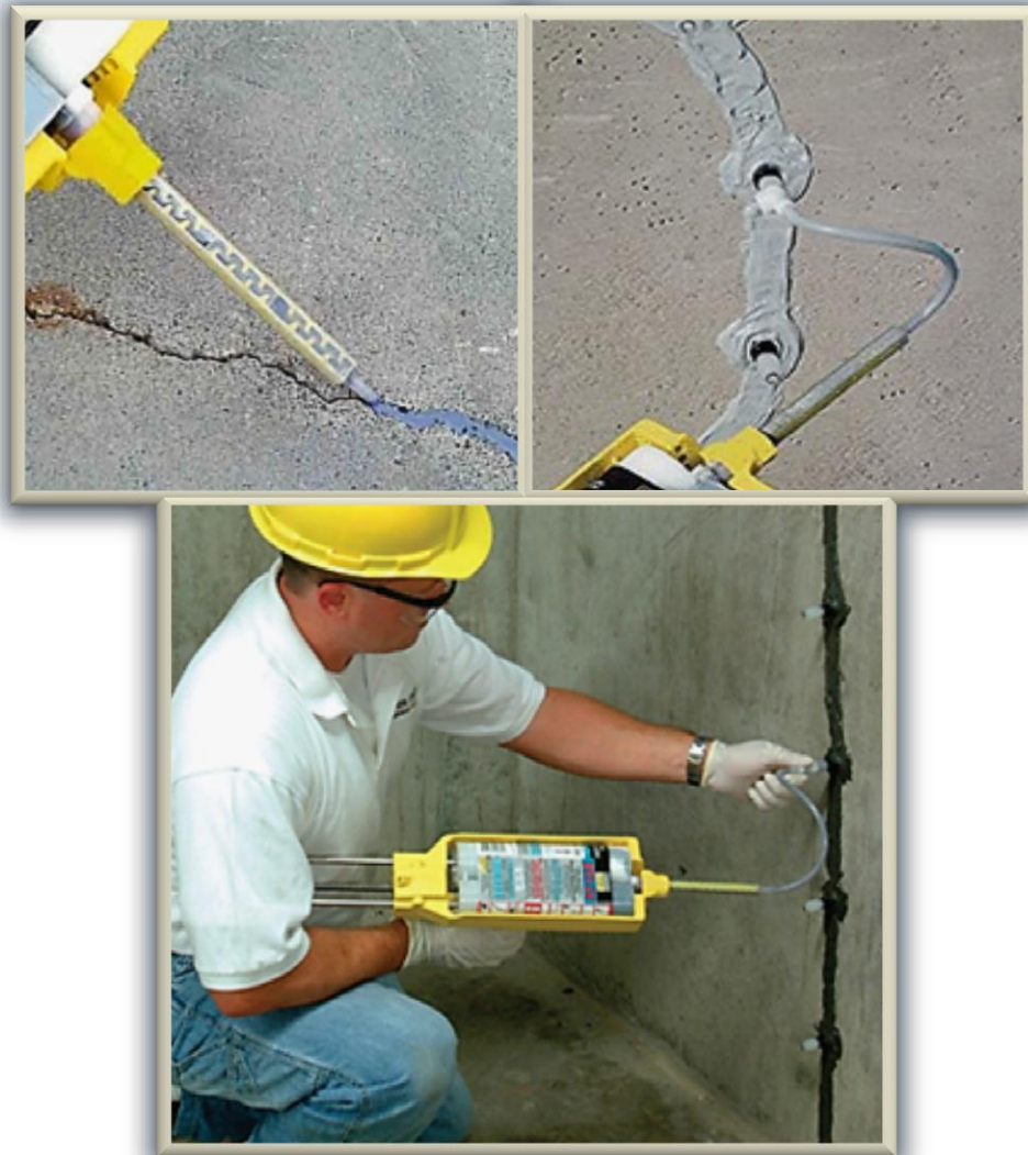
Fig. 2.3.1.2. Inyección manual de resina en grietas. Arriba izq., aplicación de forma directa sobre la fisura. Arriba der., aplicación a través de boquillas. Abajo, vista general en la que se aprecia el uso de pistola de calafateo para la inyección; nótese la separación equidistante de las boquillas
