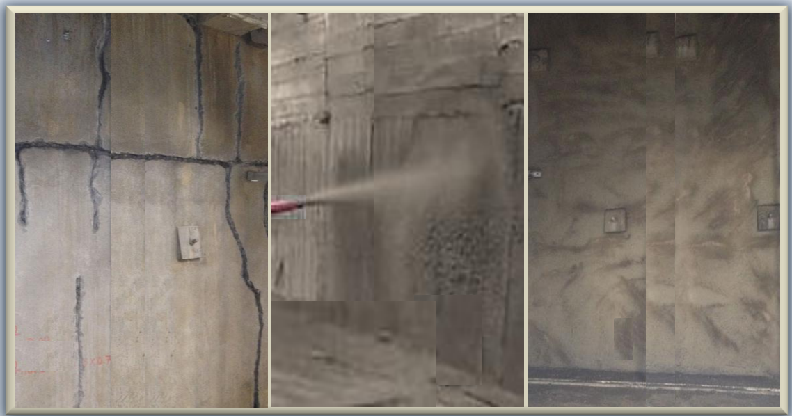
Fig. 2.2.3.3. Utilización de concreto lanzado para rehabilitación de un muro, previo sellado de fisuras con resina
