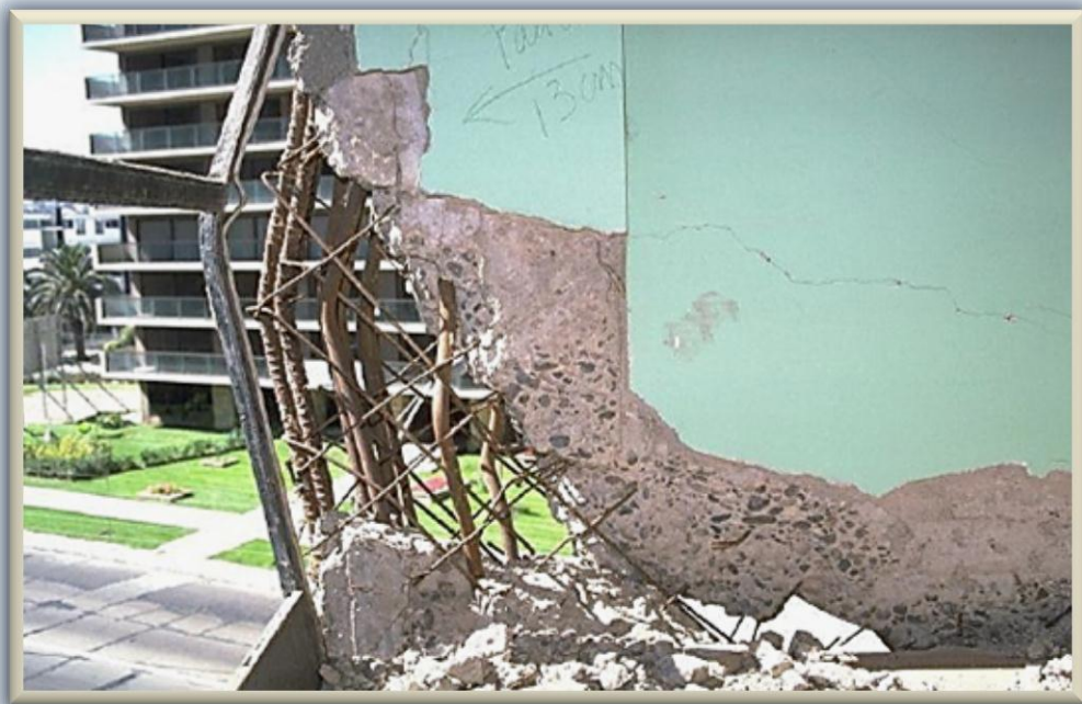
Fig. 1.2.1.e.2-2.1) Más ejemplos de falla por flexión en dirección longitudinal del muro, igualmente con trituración de concreto y pandeo del refuerzo en los extremos. Véase la escasez de estribos en la imagen superior y la nula presencia de los mismos en la inferior
