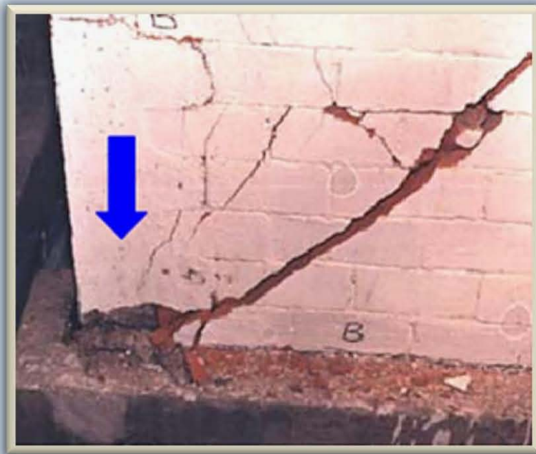
Fig. 1.2.1.f.2-1) Ejemplos de fallas típicas por cortante en mampostería. Arriba, falla debida al cambio de altura brusco del muro, acentuada por la falta de elementos de confinamiento. Abajo, no obstante de la falla a 45° del muro, el castillo se mantuvo prácticamente intacto debido a que cuenta con refuerzo transversal
