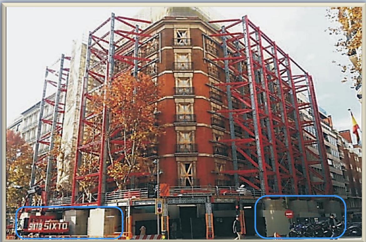
Fig. 2.1.3.8. Sistemas de soporte lateral denominados “estabilizadores”, contruidos con perfiles de acero. Arriba, estabilizadores y esquema con datos de cálculo, de una fachada de más de 10 m. de altura. Abajo, edificio de 7 niveles con estabilizadores asentados en basamentos de concreto (contrapesos)
