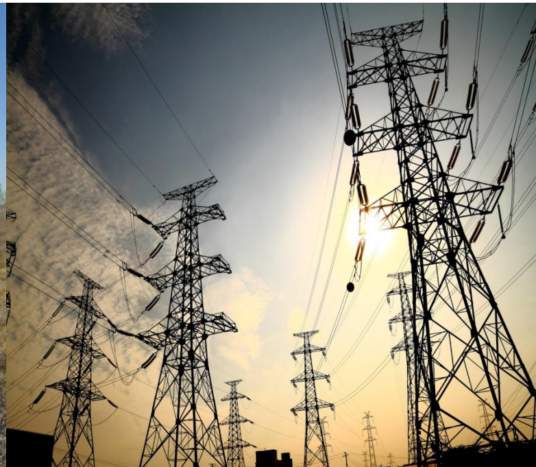
Torres de Alta Tensión
