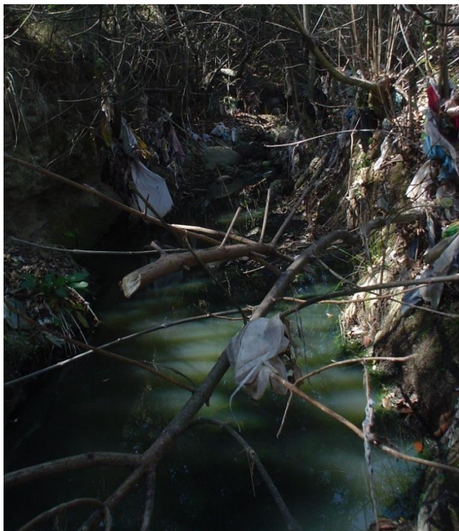
Figura III. 5 Río El Puerto. Durante una avenida el río arrastra basura de aguas arriba y esta queda atrapada entre las ramas de los árboles que están en ambos márgenes del río. La sección hidráulica que tiene el río en estas condiciones puede ayudar a imaginar la magnitud del caudal cualitativamente
