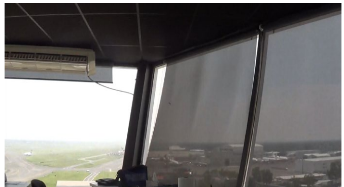
Figura 44: Ineficiencia de las cortinas
