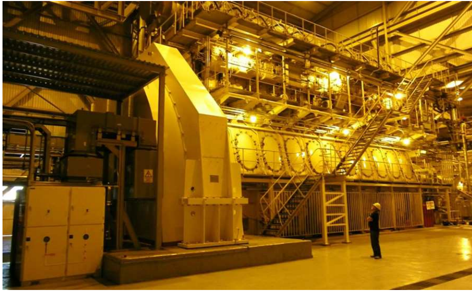
Figura 3.3. Casa de Máquinas y Turbogenerador
