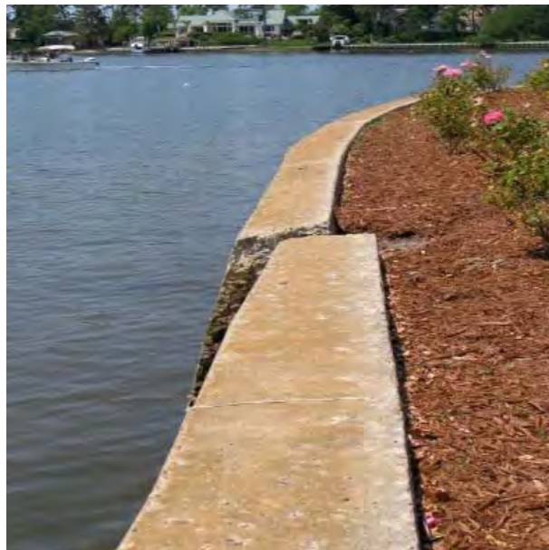
Figura 1. 12 Ejemplo de falla de un muro vertical
