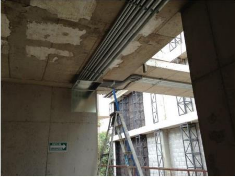
Ilustración 40. Registro de instalaciones eléctricas
