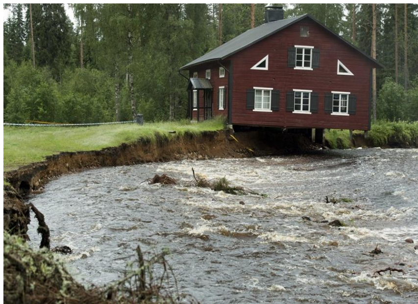
Fig. 2.4 Erosión provocada por intensas lluvias; el incremento del río se traduce en una mayor velocidad de erosión lo que provocó un descalze en la cimentación de la casa por socavación, Suecia. Recuperado de: http://enriquemontalar.com/cimentacion-descalzada-por-socavacion-un-ejemplo-sueco/
