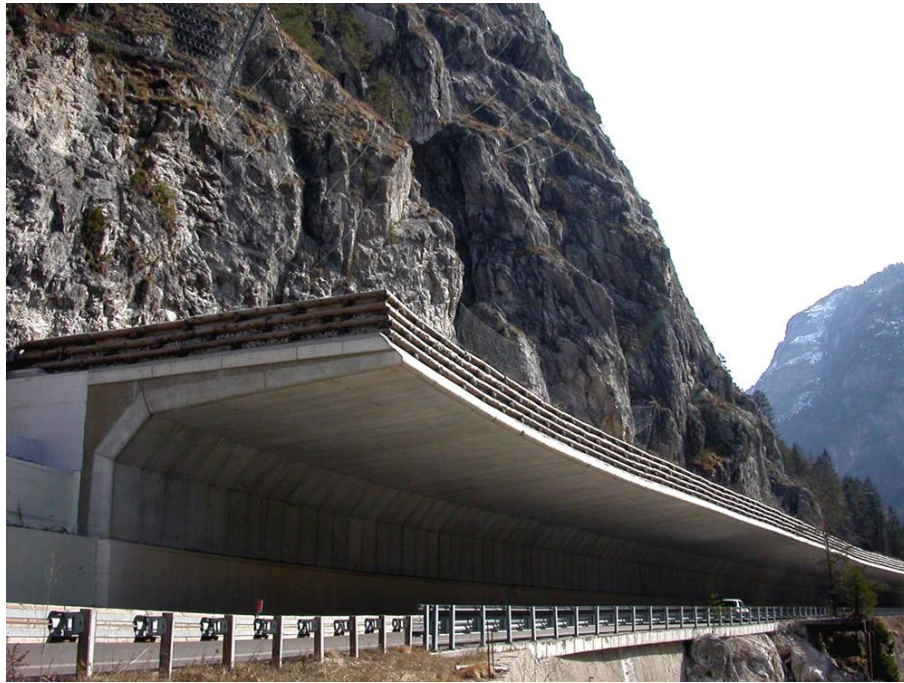
Figura 7.4.5. Túnel falso como medida de mitigación contra la caída de rocas. Recuperado de: http://www.geosistema.it/en/?id=296&cateid=16
