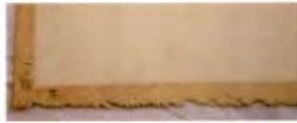
Faltantes de soporte
