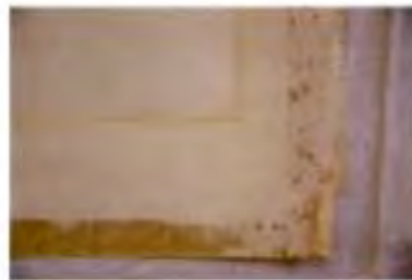
Rotura, decoloración y manchas
