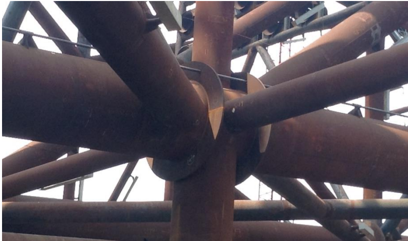
Figura 37. Anillos exteriores de refuerzo por colapso hidrostático. (Fotografía propia, 2013)
