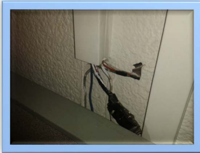
Ilustración 11 instalación eléctrica sin protección ,sin las mínimas normas de seguridad.
