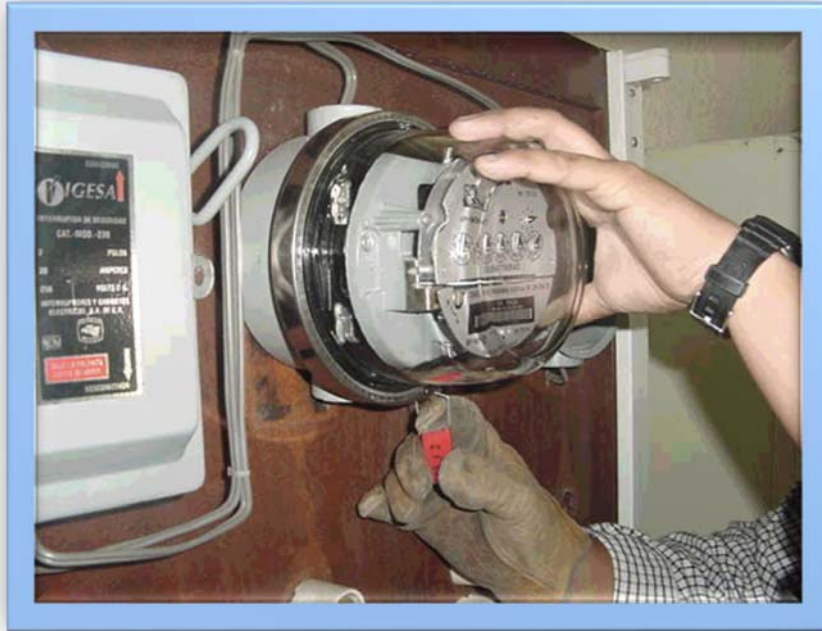
Ilustración 17. Verificación de sellos en medidor
