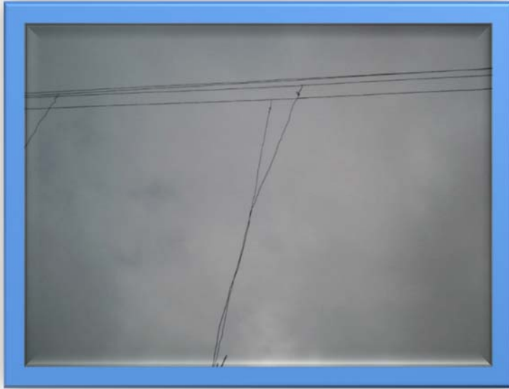
Ilustración 16 UI directo colgado, aun cuando el cable tenga forro.
