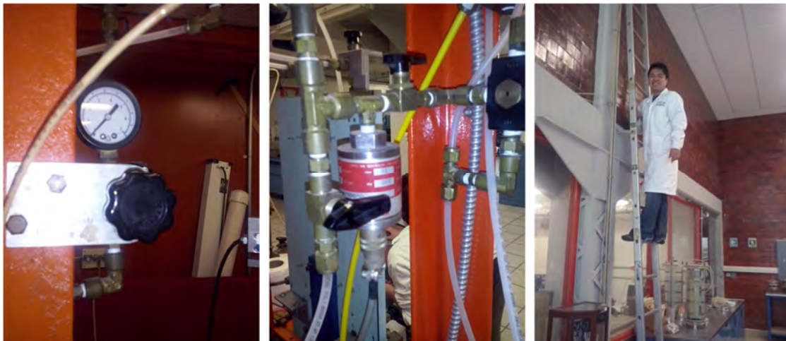
Figura 2. 11 Calibración de presión.
