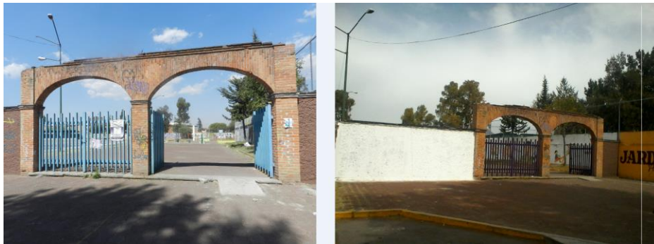
Figura 35. Estado físico del acceso principal calle Adalberto Tejeda antes (izq.) y después (der) de la intervención
