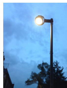
ILUSTRACIÓN 89: LUMINARIA EN CORREDOR MADERO. IMAGEN: PROPIA.
