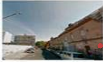
Edificio histórico Fachada en mal estado
