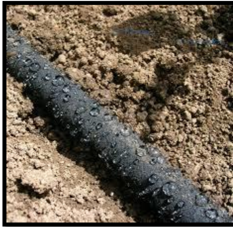
Figura 9. Imagen de tubería de riego subterránea.
