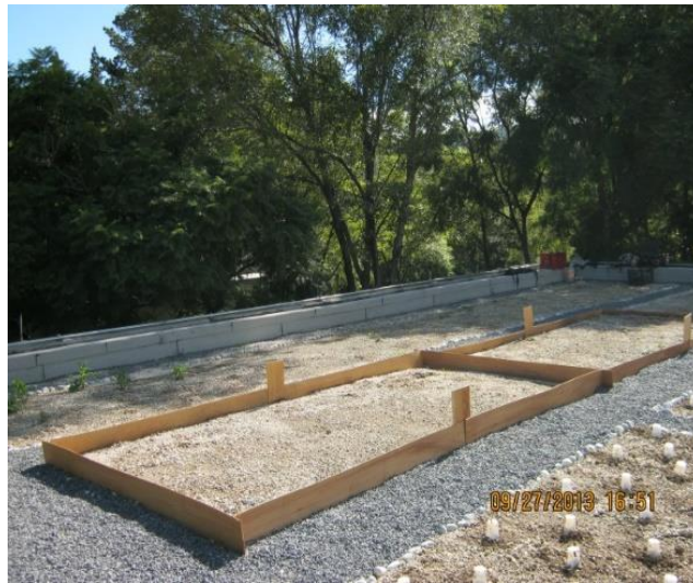
Figura 6.1. Vistas del área de estudio. Se observan tres distintas áreas, dos de ellas limitadas por láminas de triplay, previo al llenado correspondientes con sustrato.
