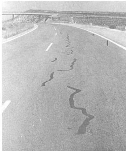
Figura 2.5.1.19 Grietas en zig-zag.
