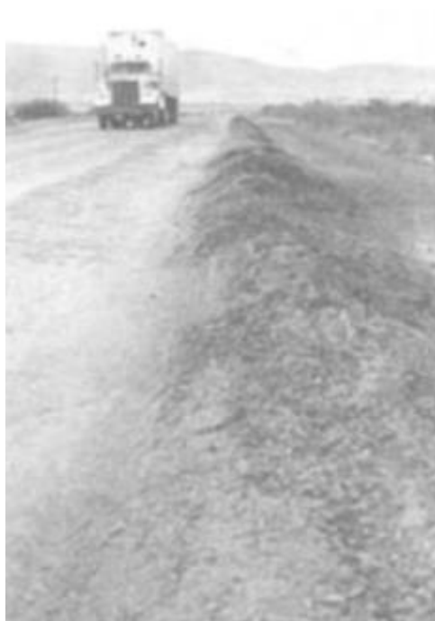
Figura 2.5.1.13 Desplazamiento de la sección del pavimento.
