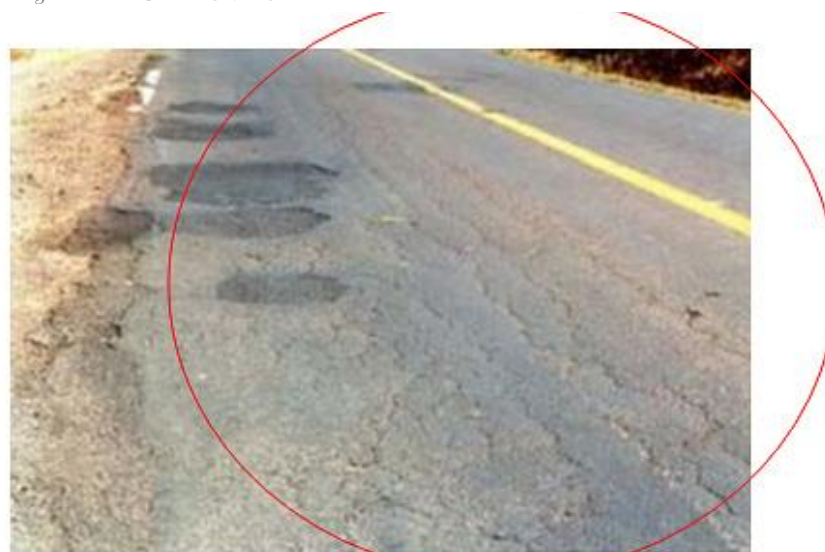
Figura 1.5.2.8 Fisuras y grietas longitudinales.
