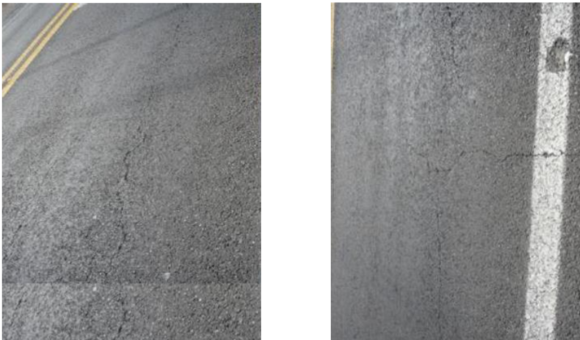
Figura 2.5.1.14 Grietas longitudinales y transversales.
