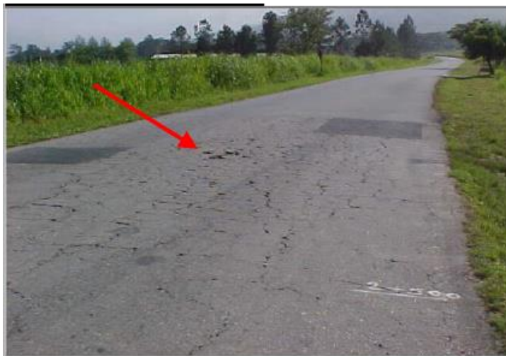
Figura 1.5.2.4 Falla por agrietamiento (piel de cocodrilo).
