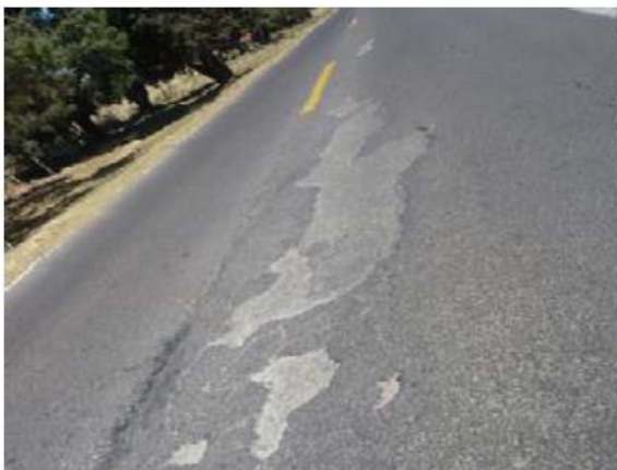
Figura 2.5.1.3 Pérdida de rodadura.
