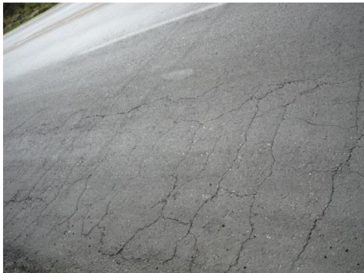
Figura 2.5.1.16 Grietas tipo mapa.
