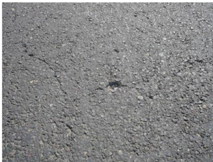
Figura 2.5.1.1 Desprendimiento de agregados.
