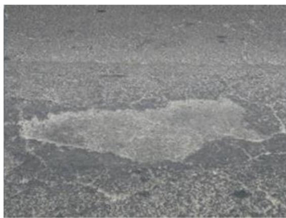
Figura 2.5.1.4 Desprendimiento de sello.
