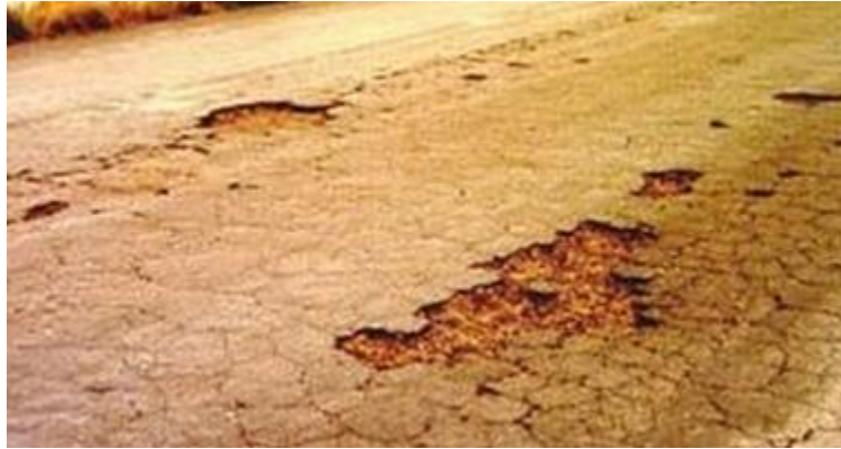
Figura 1.5.2.1 Fisuras y grietas por fatigamiento.
