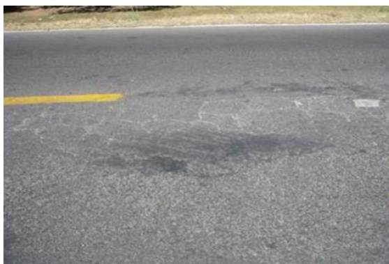
Figura 2.5.1.5 Llorado de asfalto.
