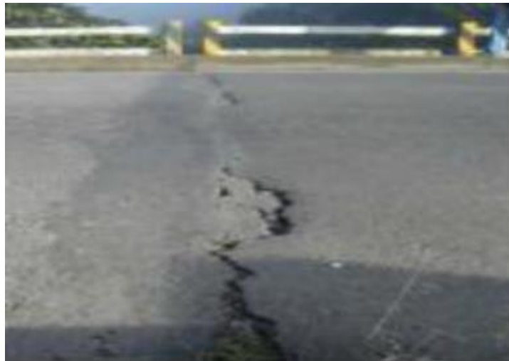
Figura 2.5.1.18 Grietas de reflexión.
