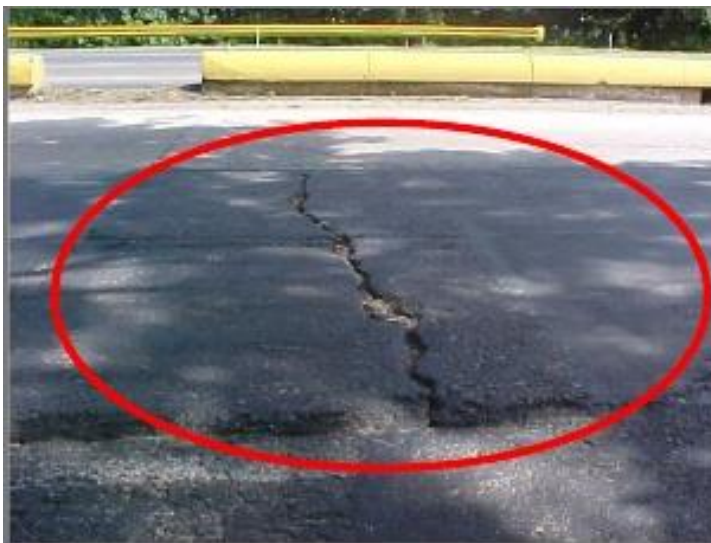
Figura 1.5.2.11 Grieta transversal en pavimento rígido.
