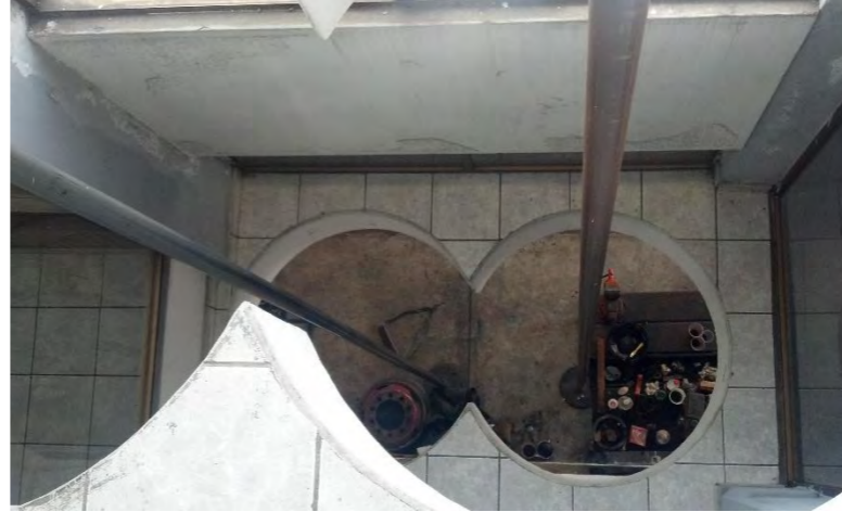
Vista de los tubos de emergencia del primer nivel.
