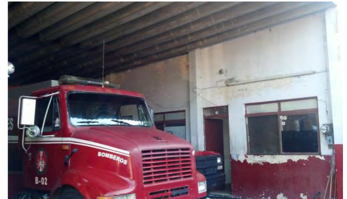
1.-La cubierta esta a una altura muy baja y se encuentra oxidada al igual que la herreria de las ventanas de los dormitorios.
