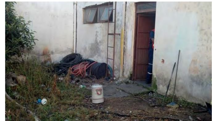
2.- Los bajantes aparte de no estar oculto, se encuentran deteriorados y el área verde, es utilizada como área de desechos.
