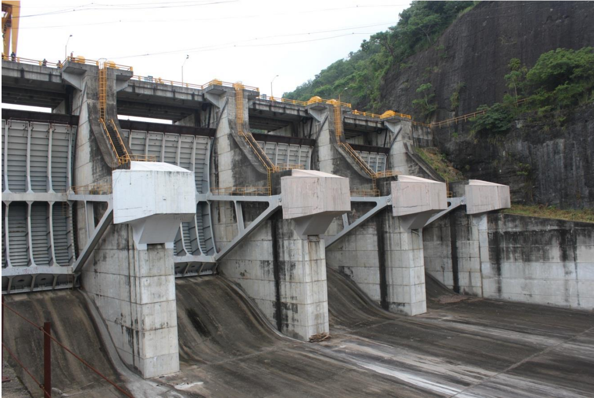
Figura 3.25 Vigas testeras en el vertedor de emergencia, condiciones originales
