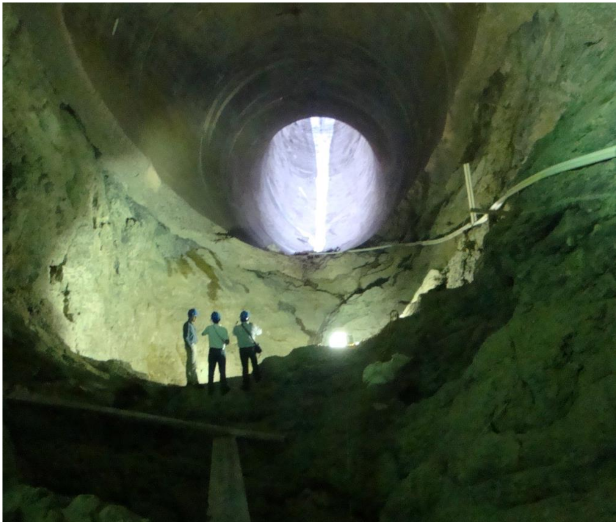
Figura 2.12 Daños importantes en uno de los túneles, C. H. Infiernillo
