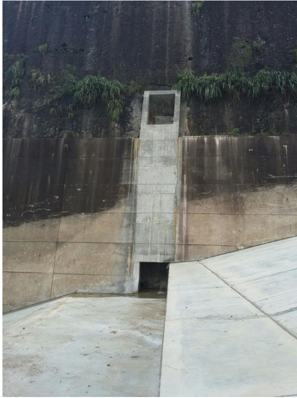
Figura 3.21 Aireador en canal de emergencia
