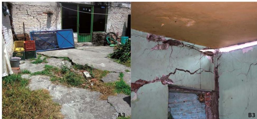
Figura 45. Fotografías A3 y B3 (Ubicadas en el mapa de la Figura 40. Mapa de lotes expuestos a zonas susceptibles y lotes vulnerables a hundimiento local y fracturas.). En la fotografía A3 se observan fracturas en el patio de una vivienda y en los muros de esta. Se observa en la fotografía B3 el interior de la vivienda, esta presenta fracturas en muros y castillos con desprendimiento de material, por otra parte la loza presenta una separación respecto a los muros, es una de las viviendas con más daños.
