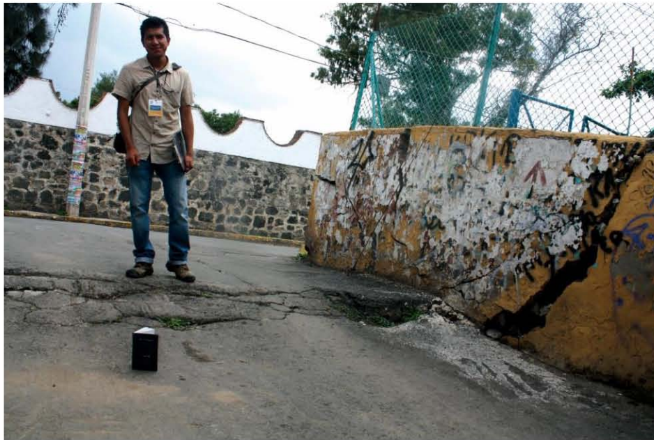
Figura 15. Fotografía C (Ubicada en el mapa de la Figura 11. Mapa de peligro por fracturas). En la imagen se observa una fractura en el pavimento con escalonamiento, ésta incide en la barda perimetral amarilla.
