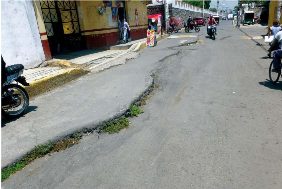
Figura 16. Fotografía D (Ubicada en el mapa de la Figura 11. Mapa de peligro por fracturas). Evidencia de una fractura con desplazamiento vertical, ubicada en la avenida Plutarco Elías Calles.
