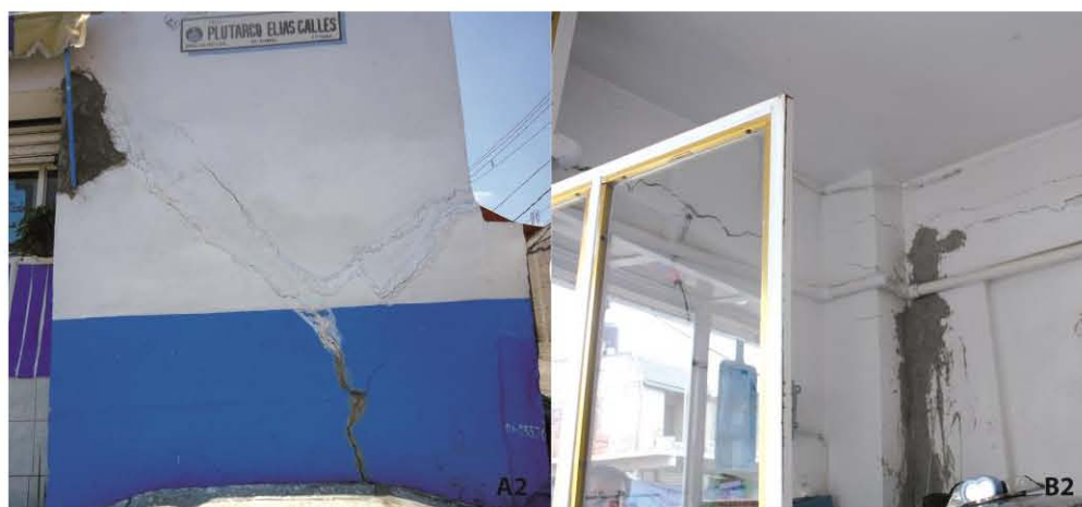
Figura 42. Fotografías A2 y B2 (Ubicadas en el mapa de la Figura 40. Mapa de lotes expuestos a zonas susceptibles y lotes vulnerables a hundimiento local y fracturas.). En la fotografía A2 se observan una serie de fracturas transversales en una purificadora de agua. Se observa en la fotografía B2 el interior de la purificadora, presenta fracturas y fisuras en sus castillos y muros.
