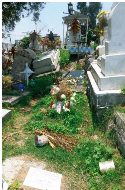
Figura 14. Fotografía B (Ubicada en el mapa de la Figura 11. Mapa de peligro por fracturas). Donde se identifica algunos daños en las construcciones dentro del panteón.
