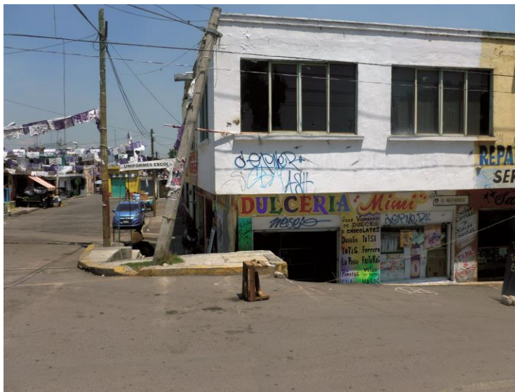
Figura 13. Fotografía A (Ubicada en el mapa de la Figura 11. Mapa de peligro por fracturas). En esta imagen se observa el hundimiento de una vivienda respecto al nivel de la calle.
