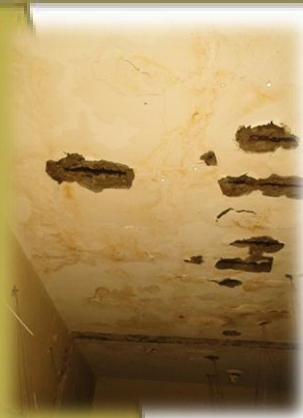
DETERIORO DE LOS ESPACIOS
