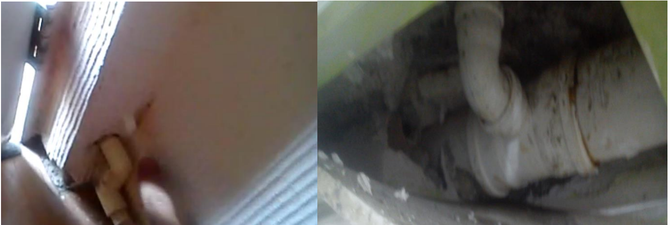
Figura 13. Desviación del agua grises al sistema de tratamiento (Anexo 4)
