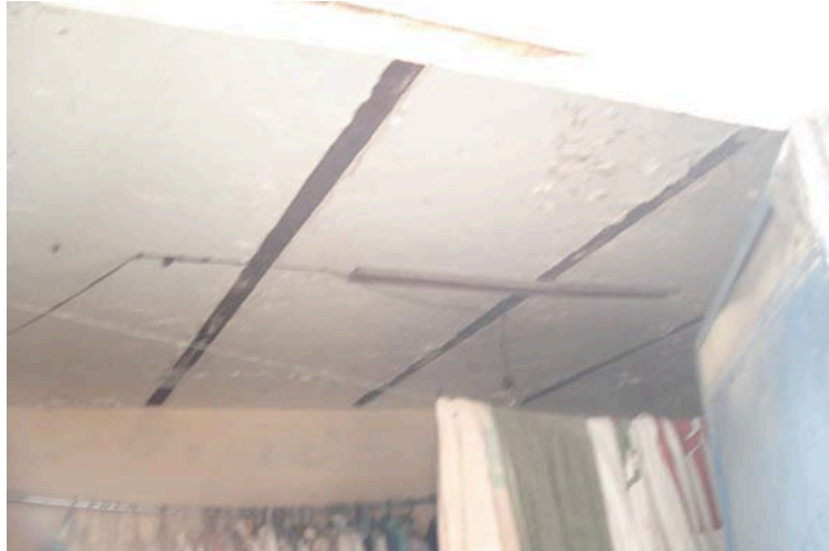
Fotografía 23 El plafón de la casa sumamente deteriorado por la humedad
