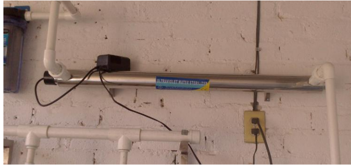
Figura 30. Sistema de purificación UV convencional (Imagen propia).
