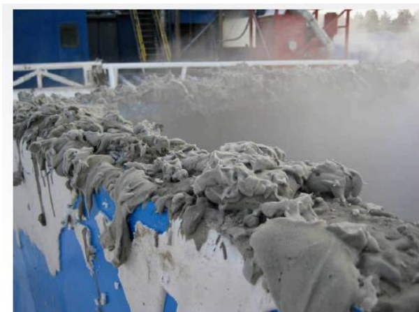
FIGURA 129. CEMENTO ESPUMADO PROCESO ZONE SEALANT, IMAGEN CORTESIA HALLIBURTON
