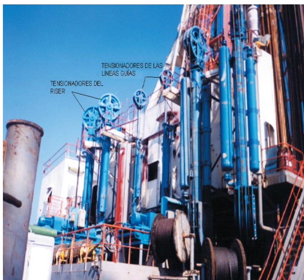
FIGURA 14. TENSIONADORES DE LÍNEAS GUÍAS.
