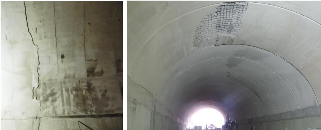
Figura 5.5. Defectos de colado en revestimiento de concreto hidráulico. Túnel Interlomas, México.
