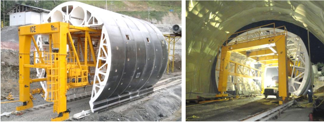
Figura 2.17. Cimbra metálica para revestimiento en túneles carreteros.
