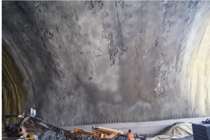
Figura 7.2. Colocación de concreto lanzado simple como revestimiento definitivo. Túneles Chimalpa I y II. (Cortesía Consultec).
