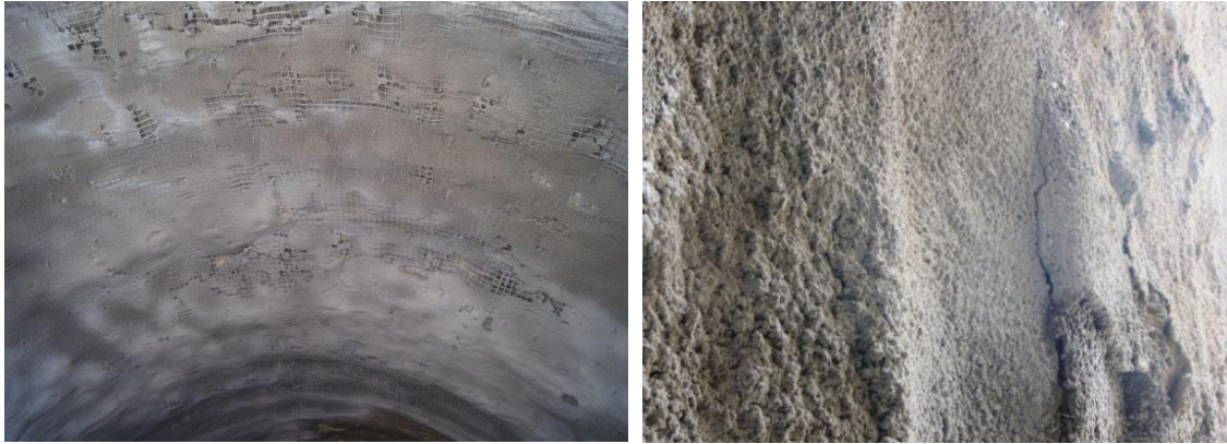
Figura 5.7. Defectos de aplicación concreto lanzado, Túnel Toluca-Nauclpan, México.
