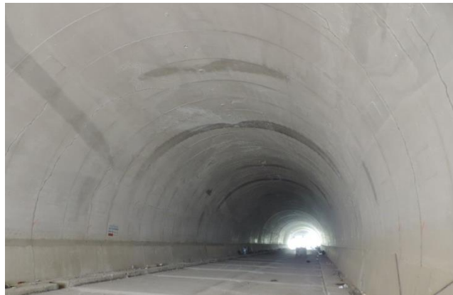
Figura 5.2. Presencia de zonas con humedad en revestimiento de concreto hidráulico.
