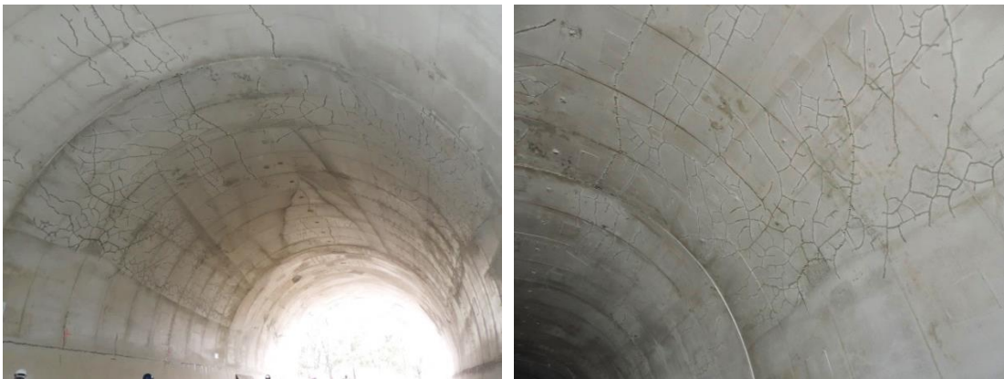
Figura 5.6. Presencia de fisuras, en un revestimiento concreto simple. Túnel Interlomas, México.
