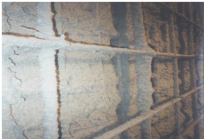
Figura 2.5. Concreto lanzado reforzado con acero (varillas), “efecto sombra”.
