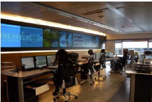
Figura 6.12. Centros de control
