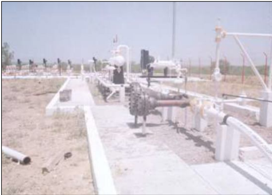
Figura 3.12 Estación Recolectora de 25 MMpcd 12
