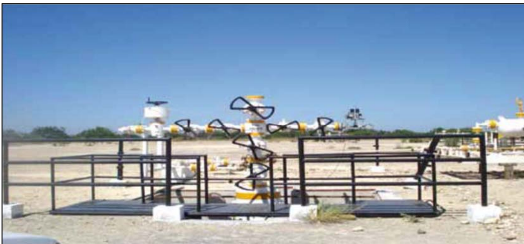
Figura 5.10 Conexión de la Instrumentación 24
