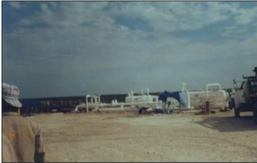
Figura 3.13 Estación Recolectora de 50 MMpcsd (1er Tipo) 12
