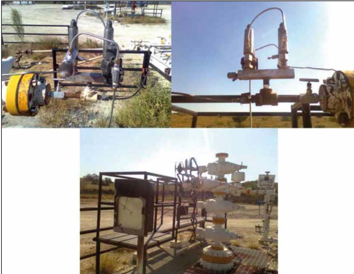
Figura 5.11 Conexión de la Instrumentación 24
