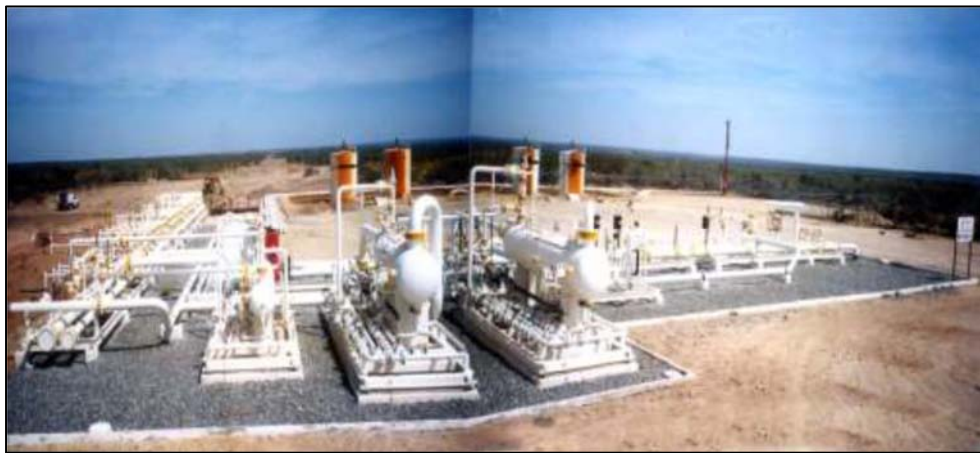
Figura 3.15 Estación Recolectora de 50 MMpcsd (3er Tipo) 12
