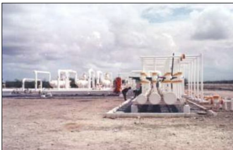
Figura 3.14 Estación Recolectora de 50 MMpcsd (2° Tipo) 12
