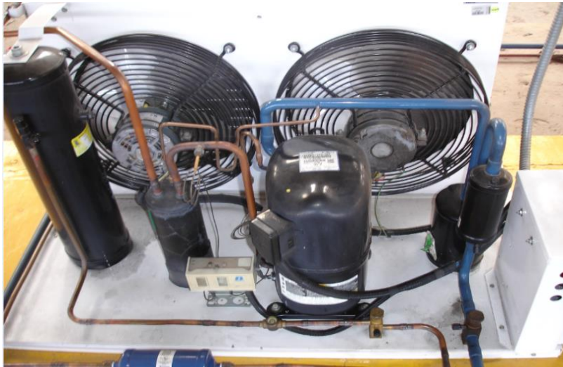
Fig. 2: Unidad compresora y condensadora analizada
