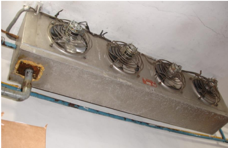
Fig. 3: Unidad evaporadora analizada
